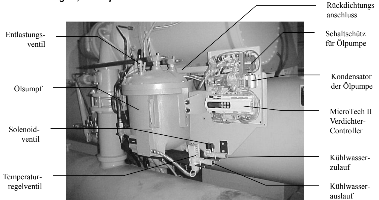
Abbildung 21, Ölsumpf und Verdichter-Steuertafel
